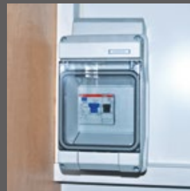
Verteilerkasten mit FI und Sicherung (16 Ampere)
